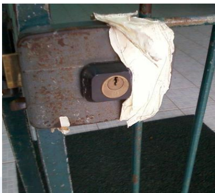
Imagem 2 — Foto postada por Isadora Faber também no dia 11 de julho de 2012, acompanhada pelo texto “O portão da escola, os problemas começam na PORTA DE ENTRADA”.
