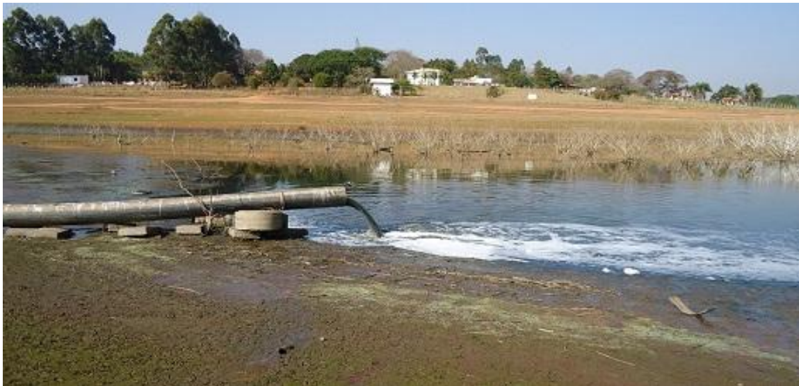
Foto 5 – Despejo de efluente no leito quase seco da represa, próximo à Rampa Náutica
