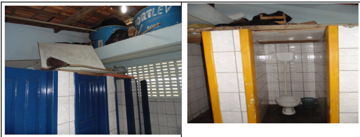
Figura 04 - Sanitários da Escola Ágata, Itabuna-BA, 2017.
